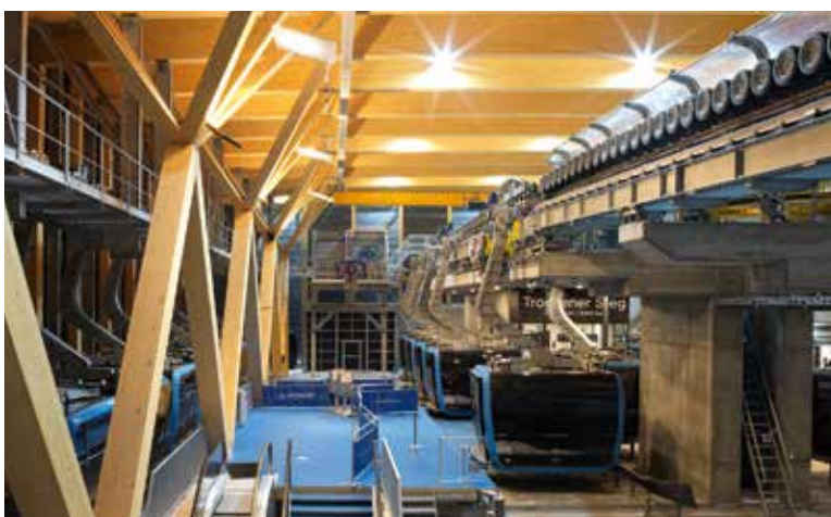
Dans le hall des gondoles au Trockener Steg, les projecteurs LED fournissent une luminosité suffisante pour les travaux de maintenance et d'entretien.
