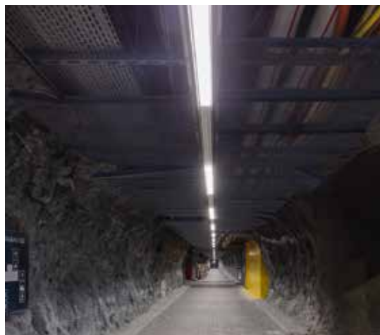
Réglettes LED posées dans le tunnel rocheux entre la station de montagne et le restaurant, le glacier paradise, la piste de ski et la plate-forme panoramique.
